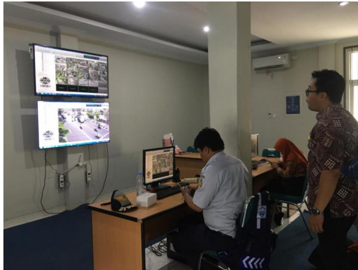
Gambar 3.5 Gambar Fasilitas dan Sarana Prasarana dari ATCS
