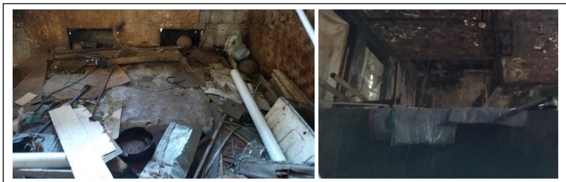
Gambar 11. Lubang ( void ) pada Lantai Interior Abattoir Cimahi
