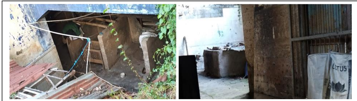
Gambar 16. Kondisi Interior Basement Abattoir Cimahi yang diduga telah Mengalami Penambahan Elemen Bangunan dari Aslinya
